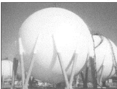
Εικόνα 7.1.2 Σφαίρα αποθήκευσης υγραερίου σε διυλιστήριο
