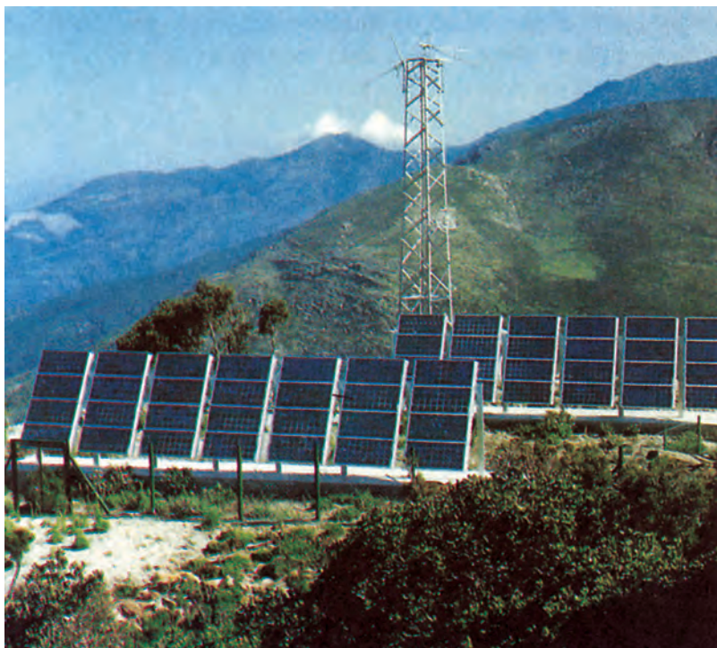
Σχήμα 1.5.3.β. Συστοιχία φωτοβολταϊκών στοιχείων.
