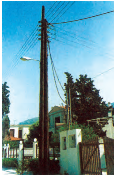
Φωτογραφία 6.1.1 Εναέριες παροχές και μετρητές ηλεκτρικής ενέργειας
