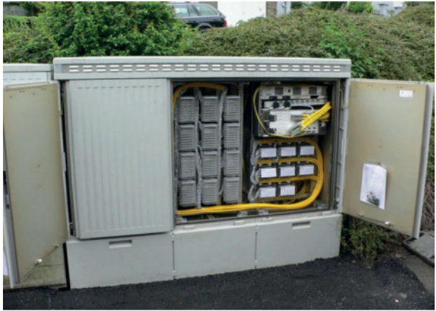
Εικόνα 5.1.4.1.β: Εξωτερικό DSLAM
