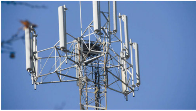
Εικόνα 2.5.β: Κεραία-σταθμός εκπομπής ασύρματου σήματος
